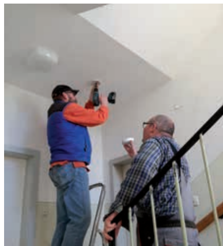
Rauchmelder in allen Wohnhäusern der Gemeinde
